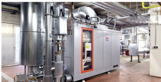
Heizzentrale mit Blockheizkraftwerk
